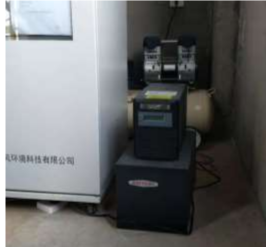
在线监测站房连续供电系统
