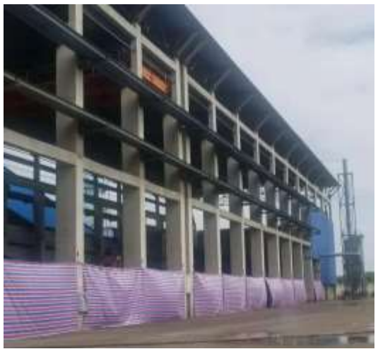
煤堆场防风围挡、防雨顶棚
