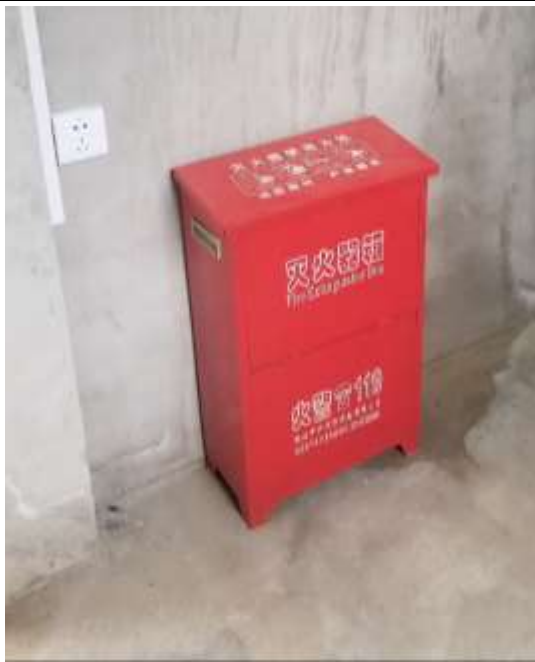
在线监测站房灭火器
